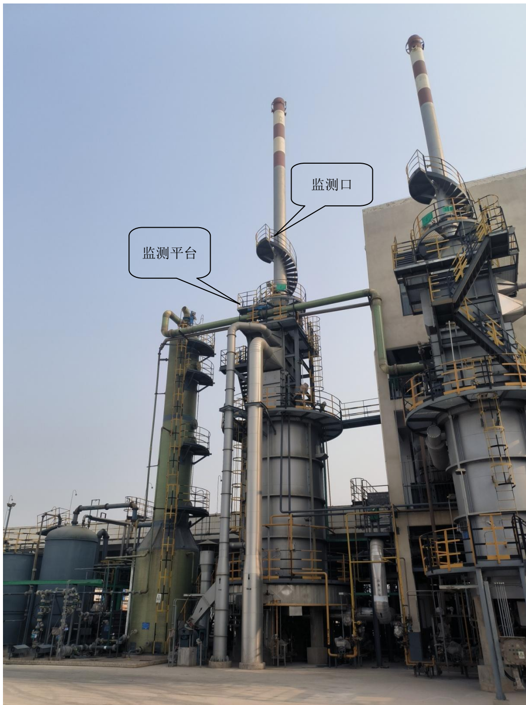
图 4.1-3 四氯化钛预热尾气排气筒实际建设情况图
