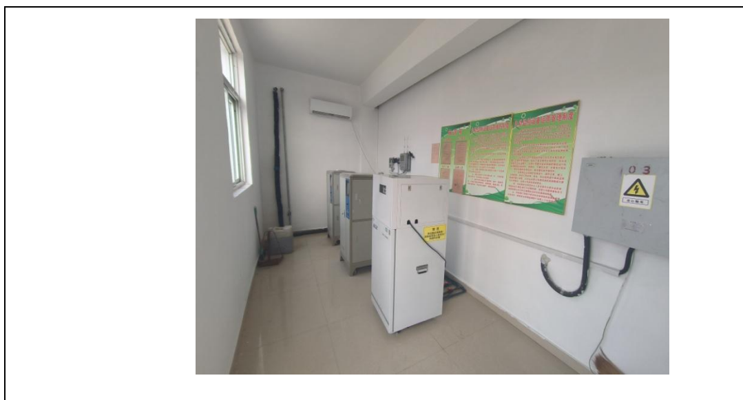
图 4.2-7 废水在线监测仪安装情况
