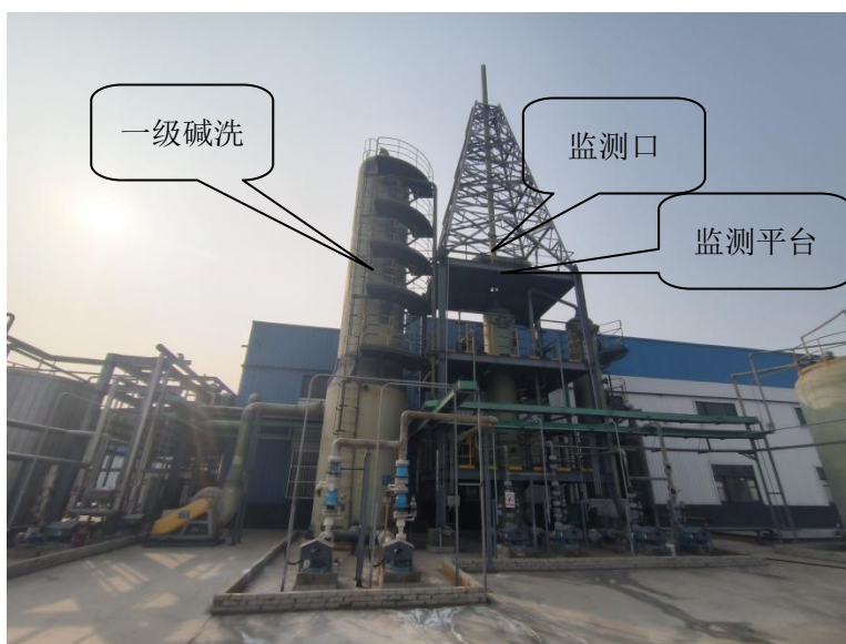
图 4.1-6 液氯气化尾气治理设施及排气筒实际建设情况图
