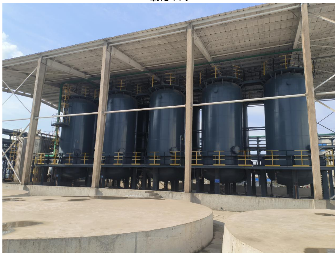
四氯化钛中间罐区
