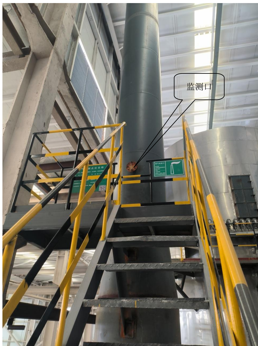
图 4.1-4 后处理车间闪蒸干燥废气治理设施及排气筒实际建设情况图
